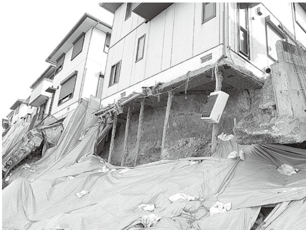
写真2 2017年台風21号の豪雨によって崩壊した盛土斜面
